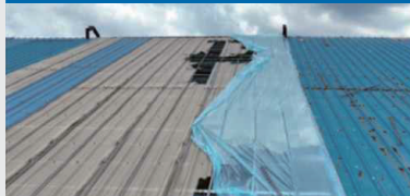
지붕재를 밟는 순간 파손되어 추락
